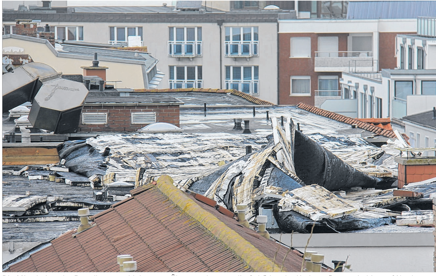
Die Mitarbeiter der Brandkasse schieben nun Überstunden, um die Schäden der Herbststürme, wie hier auf Norderney, zu regulieren.
